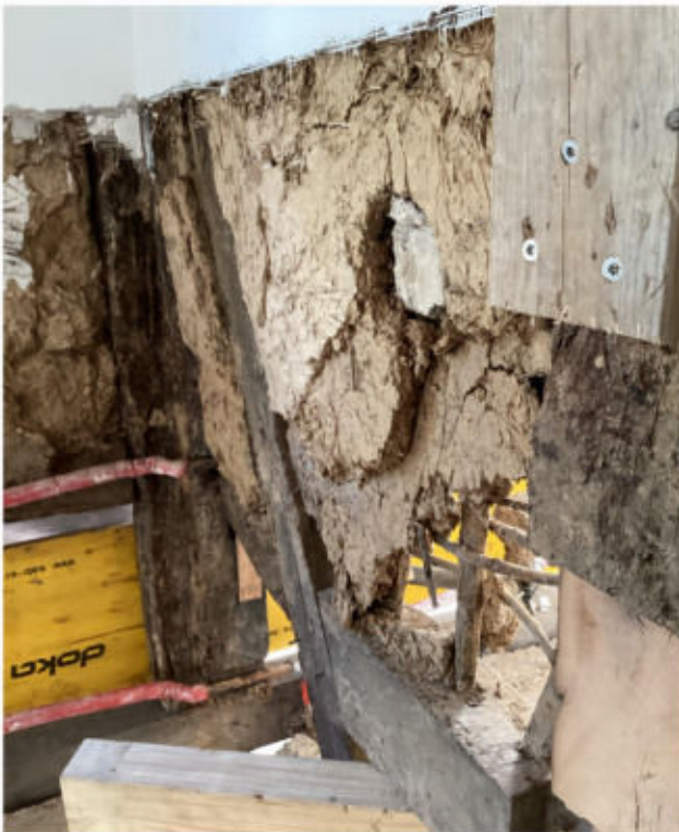
Zerstörtes Gefach (Ahrweiler)
