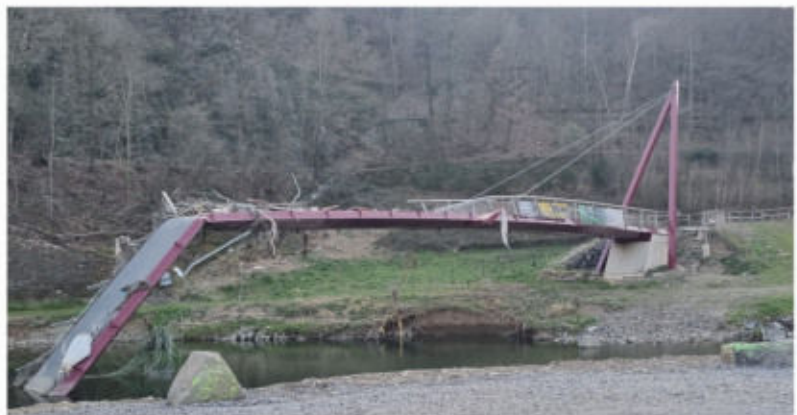
Radbrücke an der Ahr
